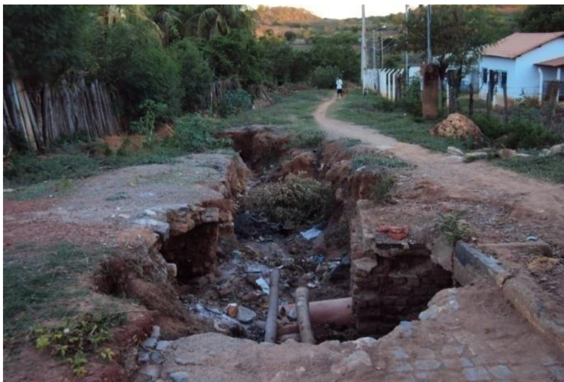
Figura 5.100 - Erosão formada na rua Alagoas no distrito de São Sebastião dos Poções, onde o material carrega para o riacho dos Poções. Fonte: Ecoplan-Lume-Skill, 2011.
