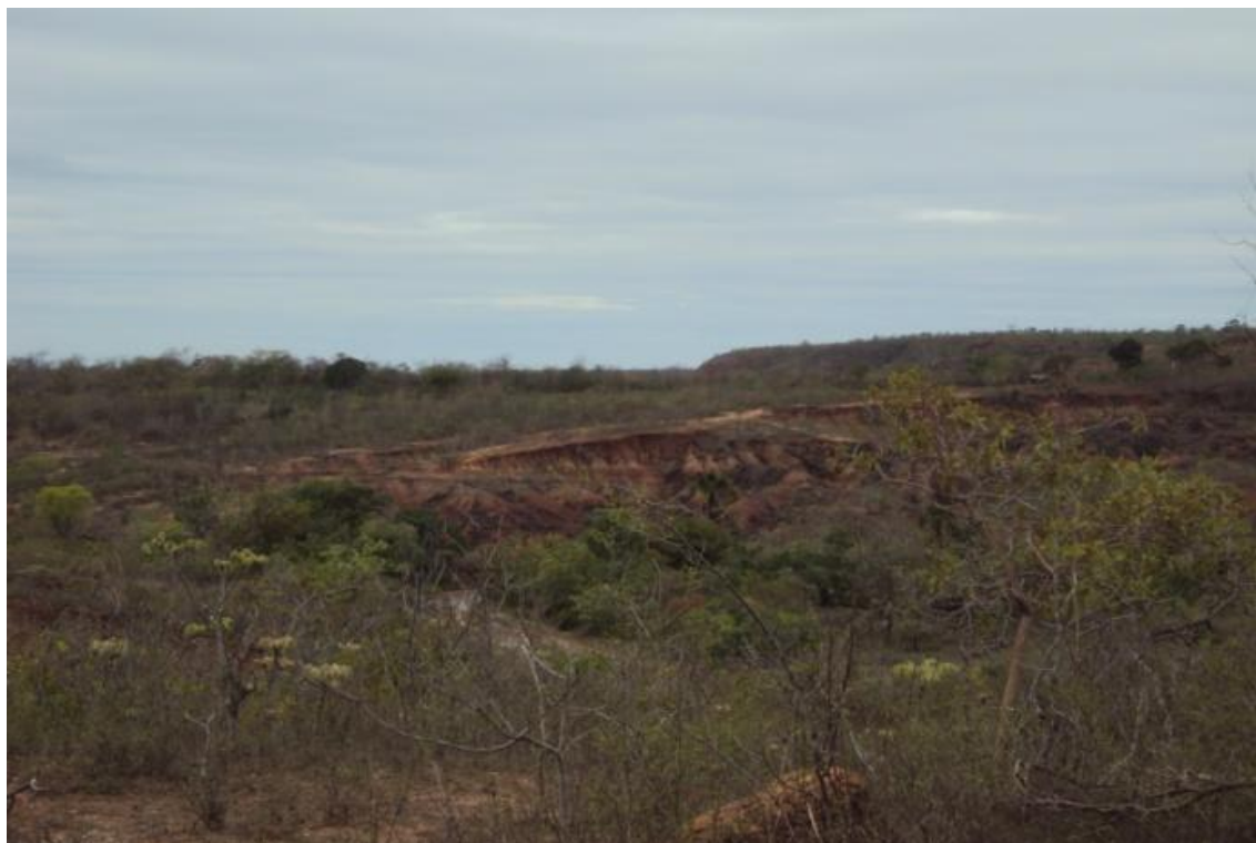
Figura 5.8 - Focos erosivos às margens da vereda Barrocão. Fonte: Ecoplan-Lume-Skill, 2011.
