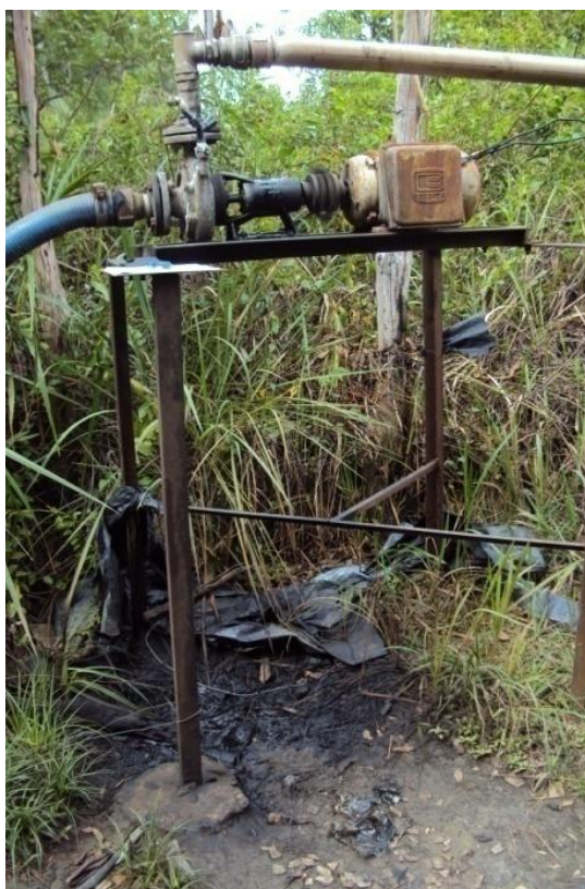
Figura 5.40 - Vazamento da bomba de captação que se encontra próxima ao ribeirão. Fonte: Ecoplan-Lume-Skill, 2011.
