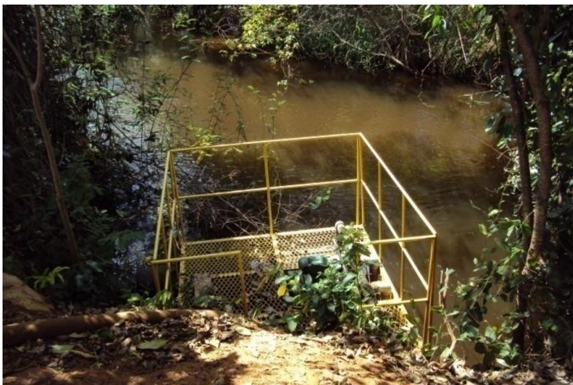
Figura 5.90 - Captação destinada ao abastecimento, após tratamento convencional realizado pela COPASA, para o distrito de Capitânia. Fonte: Ecoplan-Lume-Skill, 2011.
