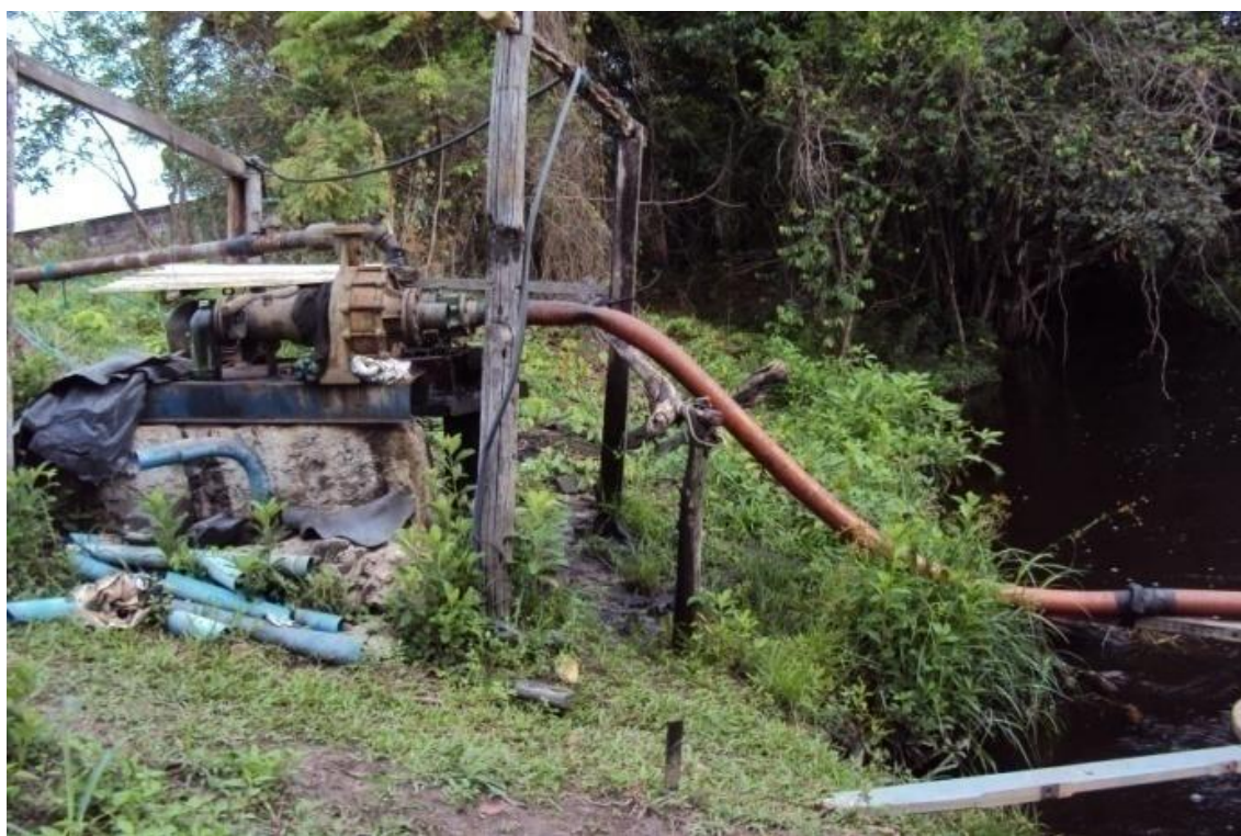
Figura 5.21 - Derrame de óleo da bomba da captação do distrito São Joaquim, às margens do córrego Jaboticaba. Fonte: Ecoplan-Lume-Skill, 2011.
